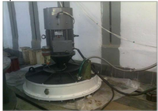
Рис. 4. Общий вид конструкции маховикового НЭ, используемого в троллейбусной сети.
